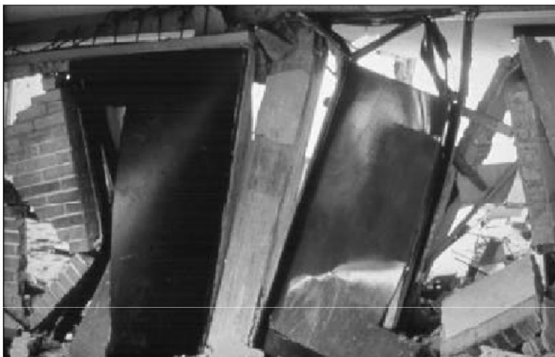
Fotografía 5. Falla de columnas por falta de sismorresistencia
