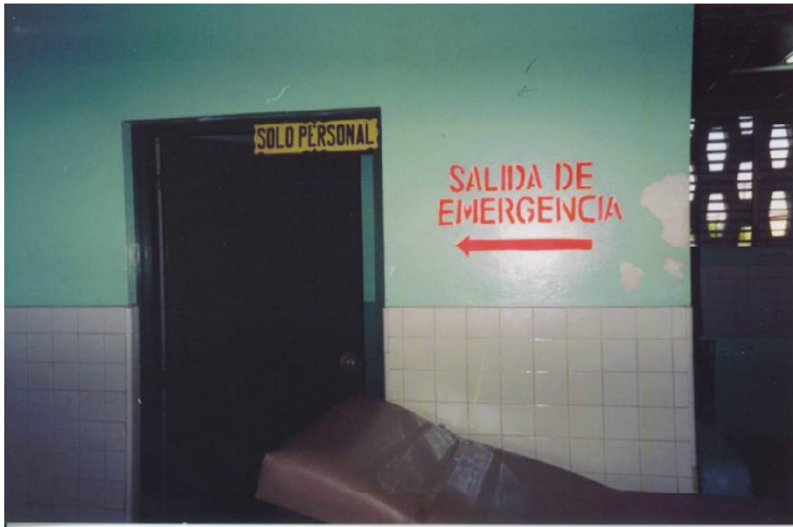
SEÑALIZACION DE SALIDA DE EMERGENCIA
