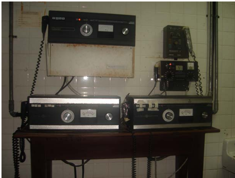
Panel de control de equipo de Rayos X
