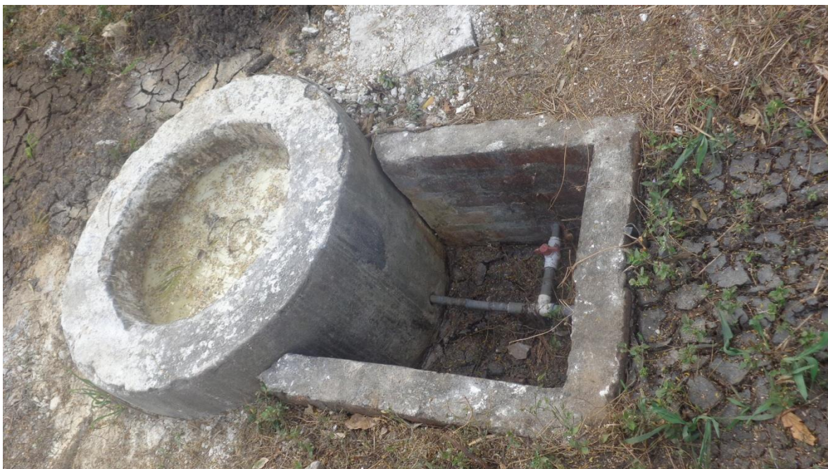
Imagen N°7. Fosa séptica de la granja rebasada de agua y llena de lodo.
