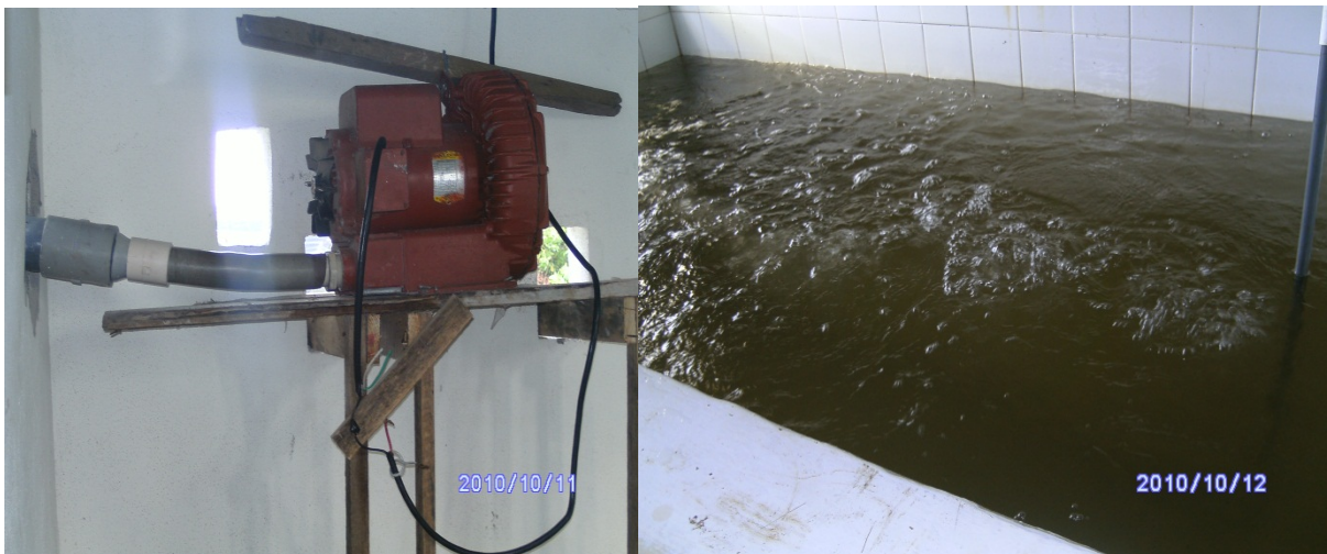
Aireador blower marca Fúji 5HP. Aireación en la pila.
