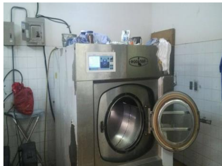
Lavadora con alta tensión eléctrica. Falta de orden al colocar objetos sobre lavadora.
