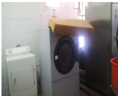
Lavadora con alta tensión eléctrica
