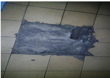
Riesgo de caídas por piso en mal estado
