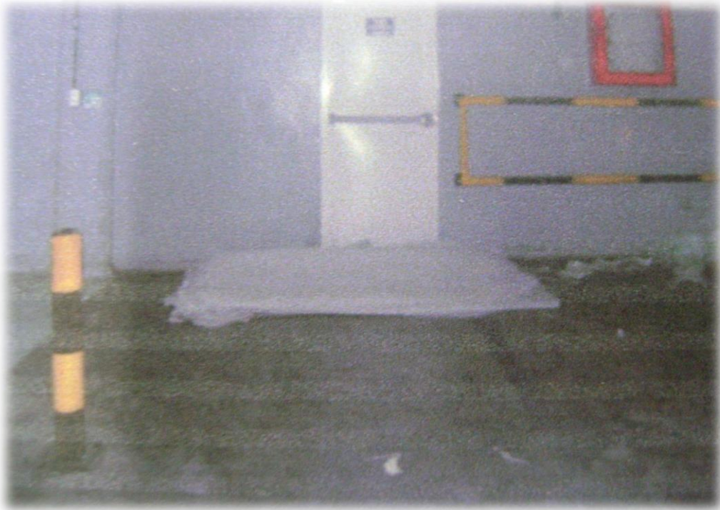
Figura 1.8: Salida de emergencia obstruida
