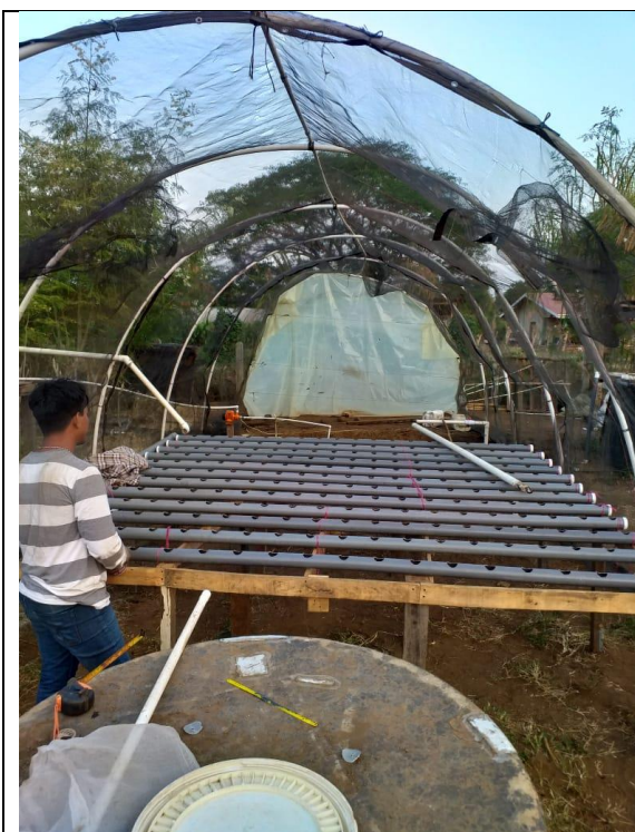
Instalación total del sistema NFT
