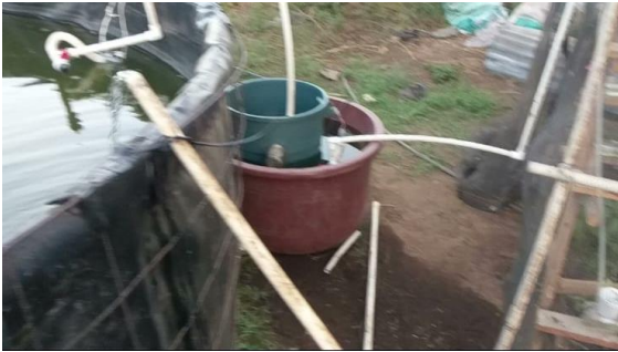
Figura 9. Filtro mecánico del sistema acuapónico.
