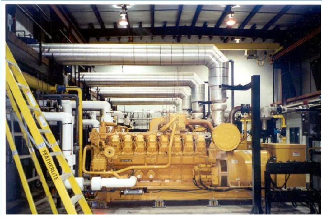
Figura 10. Sistema de energía modular para convertir el biogás en energía eléctrica.
